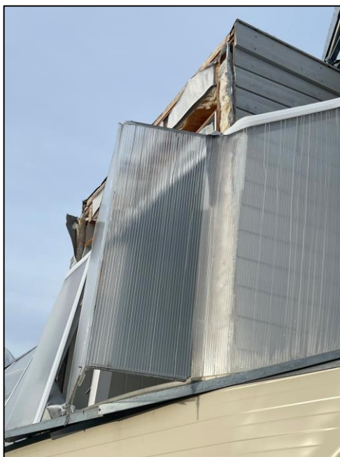
Figur 52 Drivhus i Grimstad som har blitt knust av vind og snølast våren 2024 [1].
