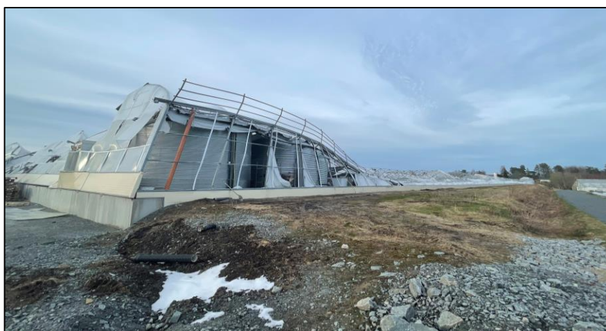
Figur 17 Bilde av deformert drivhus i Grimstad [1].
