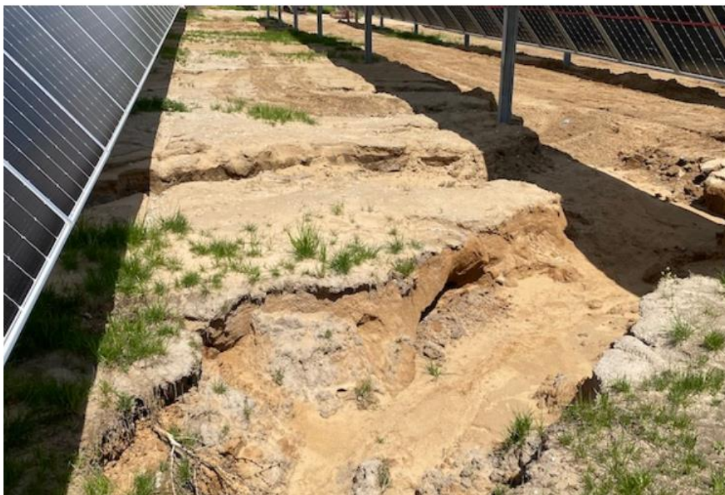
Figur 3.5 Eksempel på erosjon ved en pakkemontert solcellepark i USA[33]
