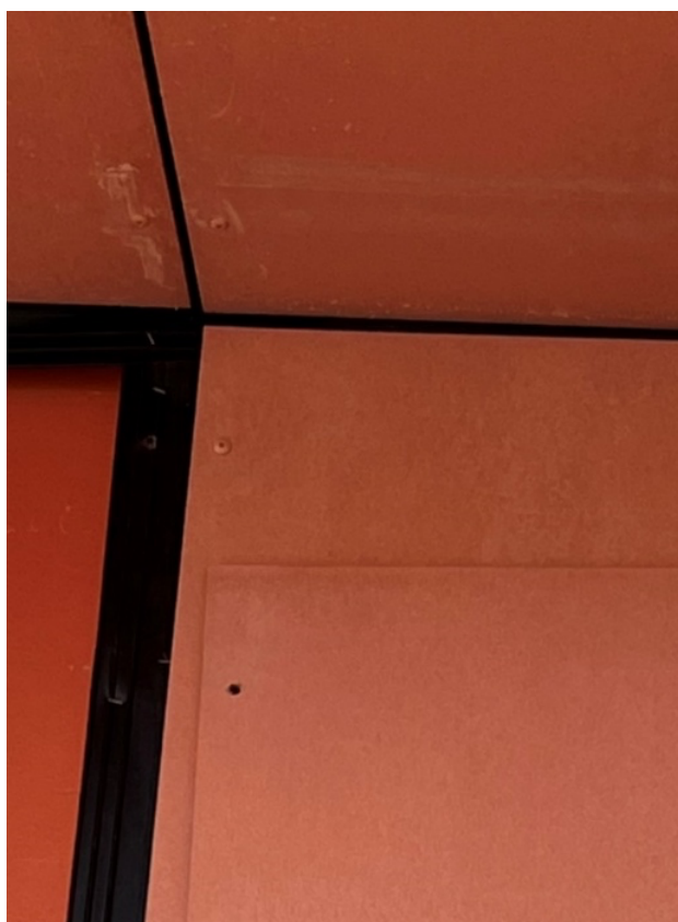
Figur 5-22 For stor glippe mellom vegg og himling
