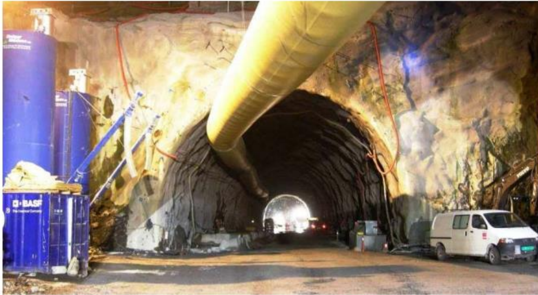
Figur 3.5 Ventilasjonsskanal og påhugg, Bærumstunnelen
