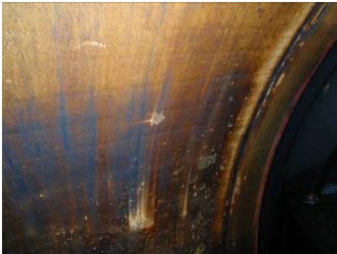
Bilde 15: Bilde av overgangen mellom tromme og kuleventil
