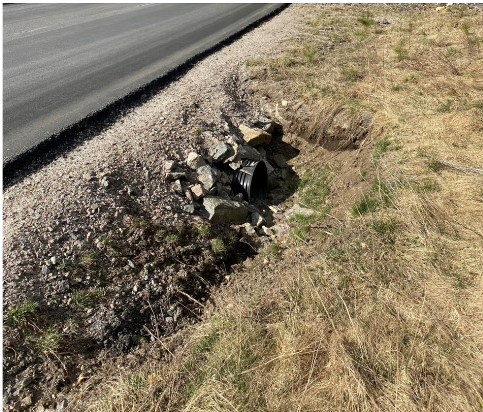
Figur 7-15 Innløp DN 400 stikkrenne ut i Guslåtjørna. [Foto: Jon Olav Upsal]
