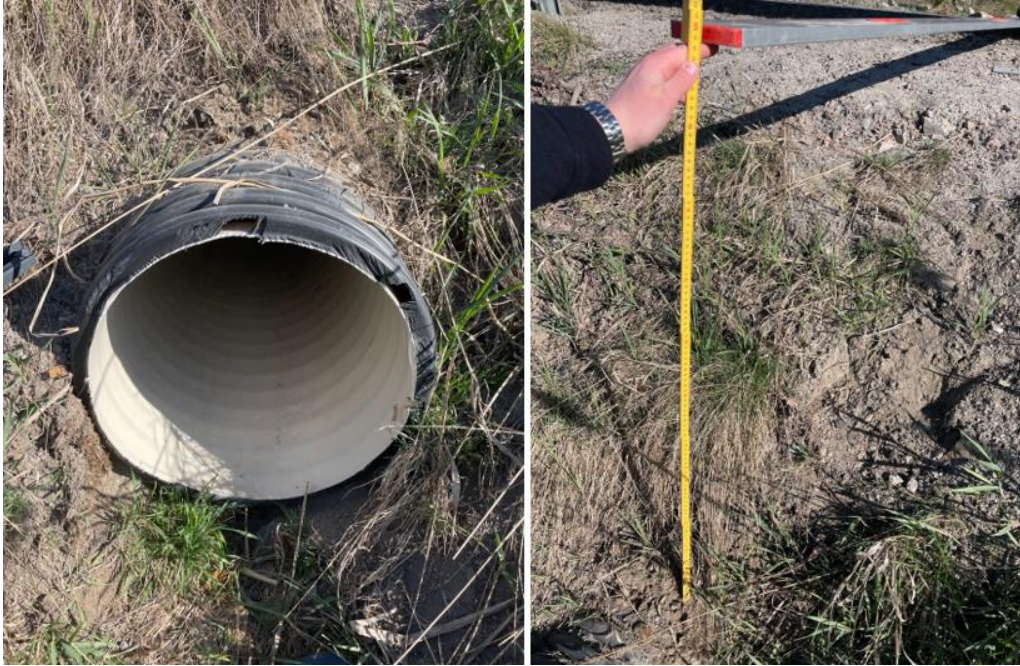
Figur 7-14 Utløp DN 400 stikkrenne ut i Guslåtjørna, bilde t.v. utløp stikkrenne og bilde t.h. måling av dybde fra topp slitelag til toppen av stikkrennas utløp ca. 99 cm. [Foto: Kristian Kolstad, 29.04.2022]
