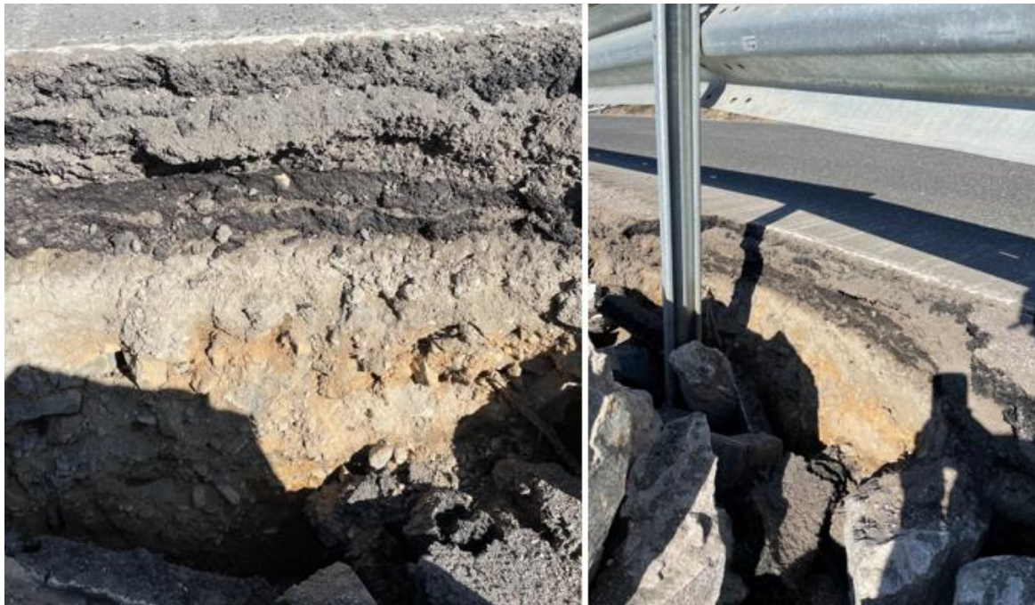
Figur 7-18 Synlige lag i overbygningen ved autovern, begge bilder er tatt på samme sted bare med litt ulik avstand. [foto: Kristian Kolstad, 29.04.2022]
