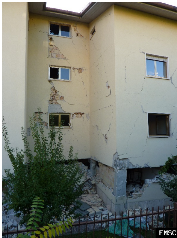
Figur 1.1 Skade på en betongbygning i L' Aquila, Italia fra et jordskjelv 2009 omkring 7 km fra episenter med en magnitudo på 6,3 på Richters Skala. Foto av F. Stoppa. [2]
