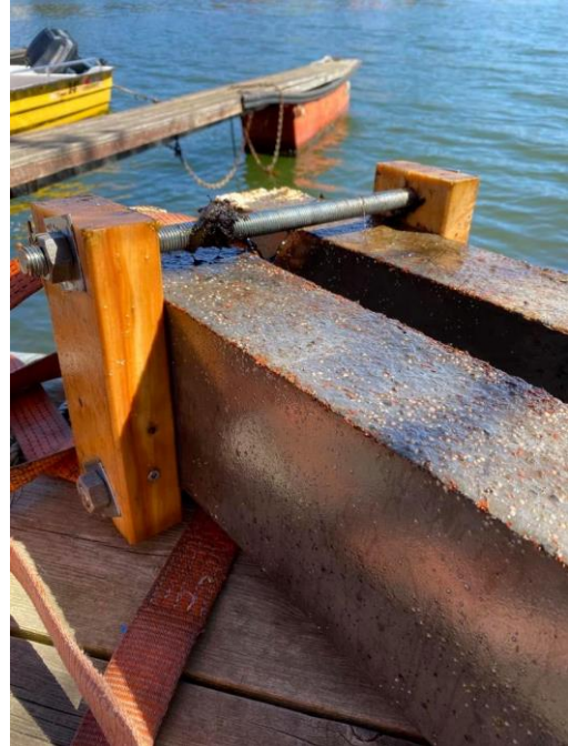
Figur 1.1: Korrosjonsskade på betongkonstruksjon. Privat foto
