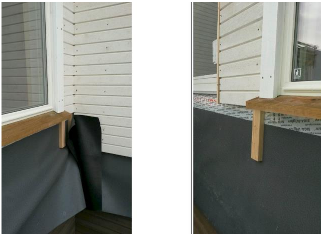
Figur 12-6 Eks på dårlig tettingsarbeid. Her satt for lavt
