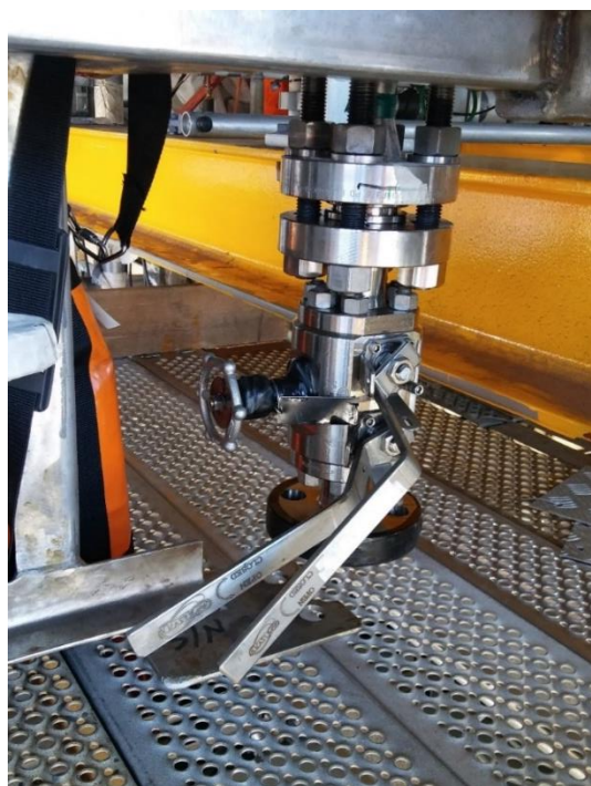
Figur 5-6: Stålplate montert under ventilen på grunn av en tidligere revisjon
