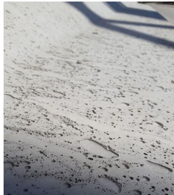
Figur 7.20: På oversiden av underflensen til omvendte T-bjelker og I-bjelker dannes det porer
