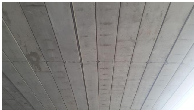
Figur 7.21: Undersiden av prefabrickert bro i Danmark med påkjørselsskade (Foto: John-Erik Reiersen, Betongelementforeningen)
