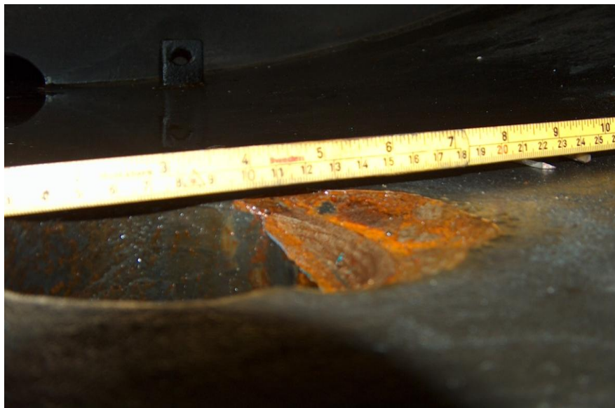
Figur 22 spyledyse ute av stilling Her er det en spyledyse som er kommet ut av stilling og gravd grop på 18mm dybde ved siden av stussutløpet.
