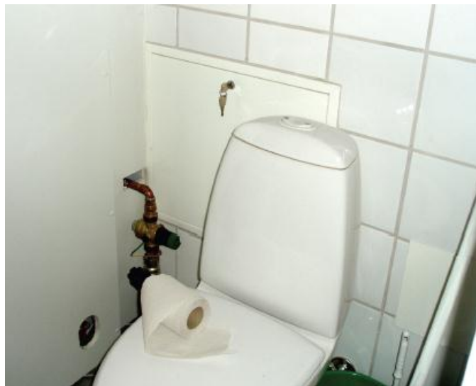
Figur 18 Fordelerskap er plassert utilgjengelig bak toalett (SINTEF Nasjonal database for Byggkvalitet, 2003)
