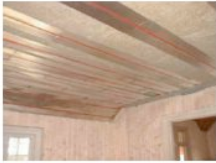
Figur 25: Utforming av lavtemperatur takvarmesystem bestående av trefiberplater og aluminiumsplater [Gundersen og Schild 2005, 23].
