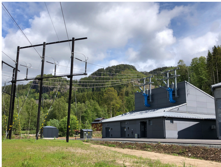
Figur 2.2: Eksempel på transformatorstasjon (Glitre Nett, 2023a)
