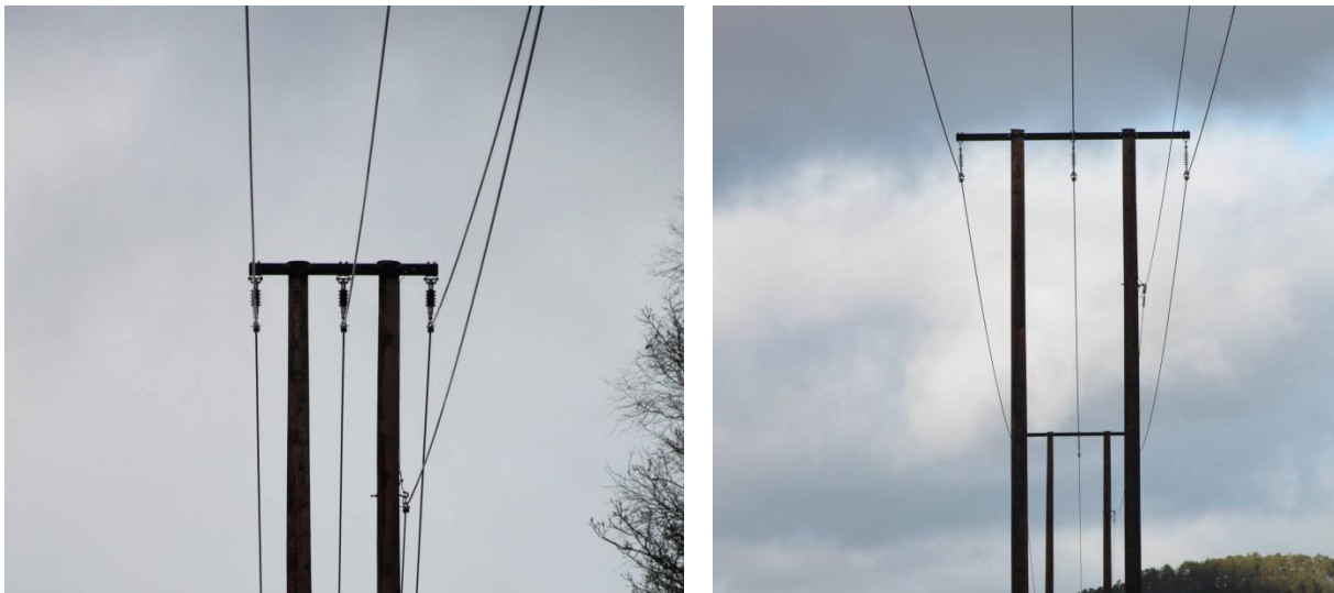
Bilde 4-1: BLL-linje på 24 kV (venstre) og FeAl-linje på 24 kV (høyre)
