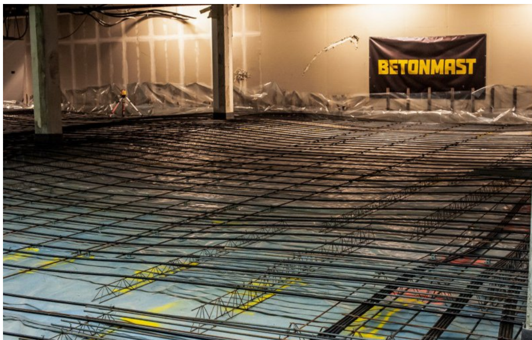
Figur 3.7: Før støp av etteroppspent fiberarmert gulv (CCL Deck) på Gulsbogen Senter i Drammen. [27]
