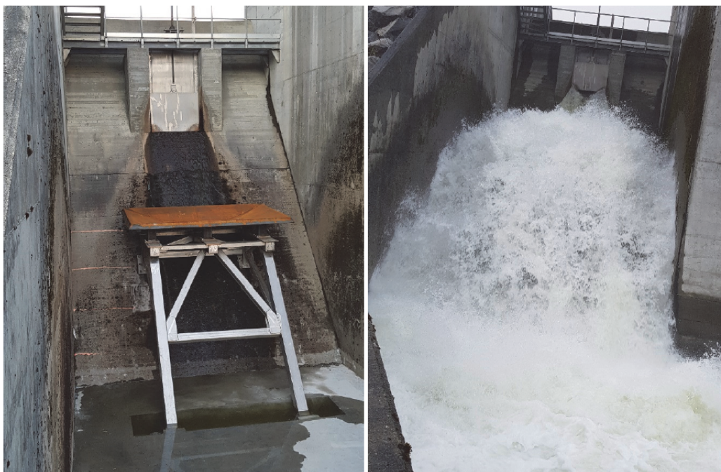
Figur 1.3: Deflektor installert ved dam Tjurrmoen i 2018. Foto: Sebastian Stranzl [8]
