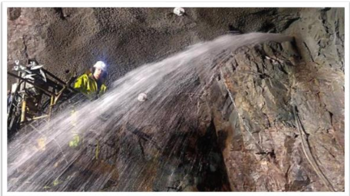
[Figur 3.1]: Vannlekkasje fra berget ved driving av Mælefjelltunnelen E134 Gvammen–Århus i
