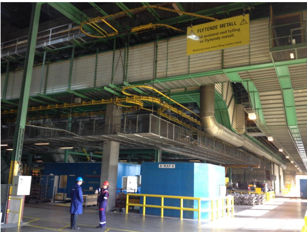
Bilde 3. Viser oppe til høyre kjølekanalene. Punkt 3. på oversiktsbildet.
