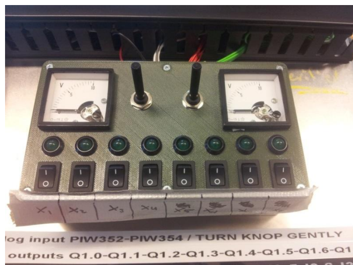
Figur 104: Kontrollpanelet hvor raden med knapper representerer forskjellige posisjoner for understrukturen. Knappen lengst til venstre er brønnrad 1, den neste brønnrad 2 osv. Lysene, potmeterene og voltmeterene er ikke i bruk.
